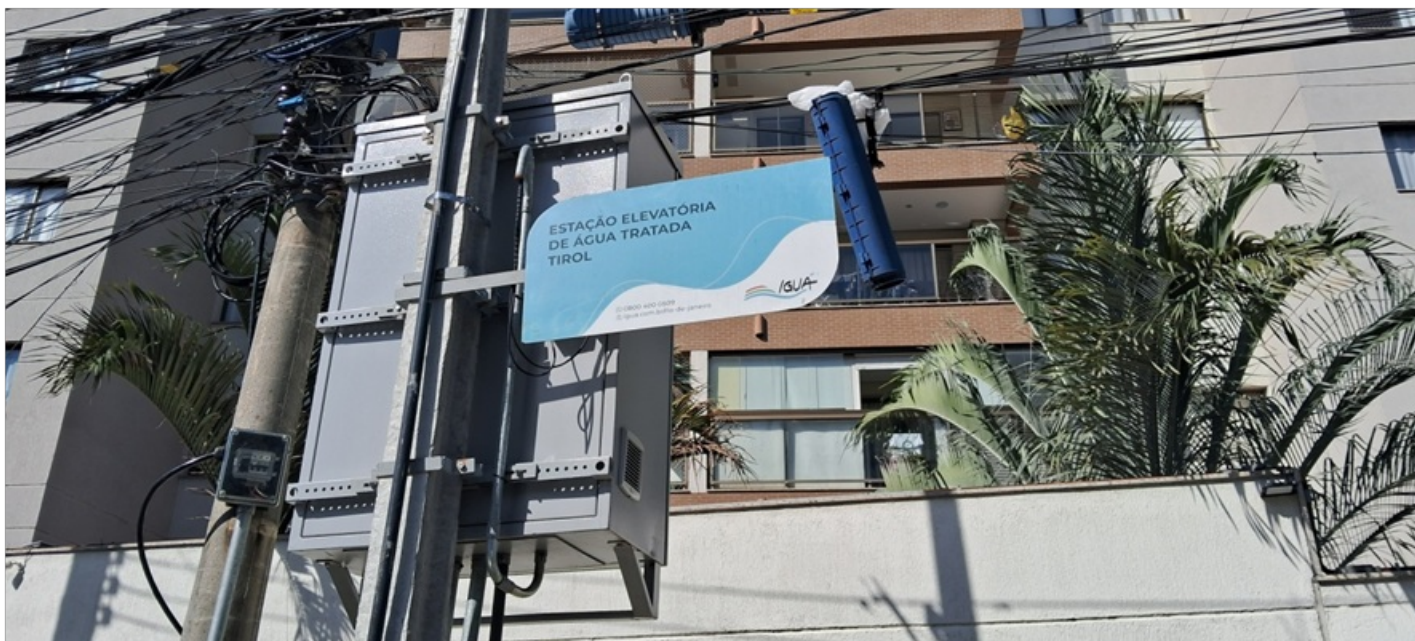
Foto 4 – Identificação da estação elevatória
