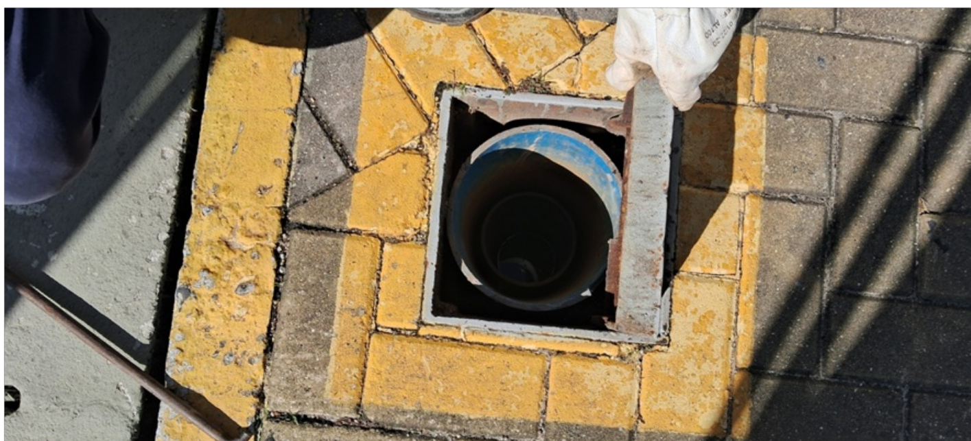
Foto 11 – Válvula de retaguarda
