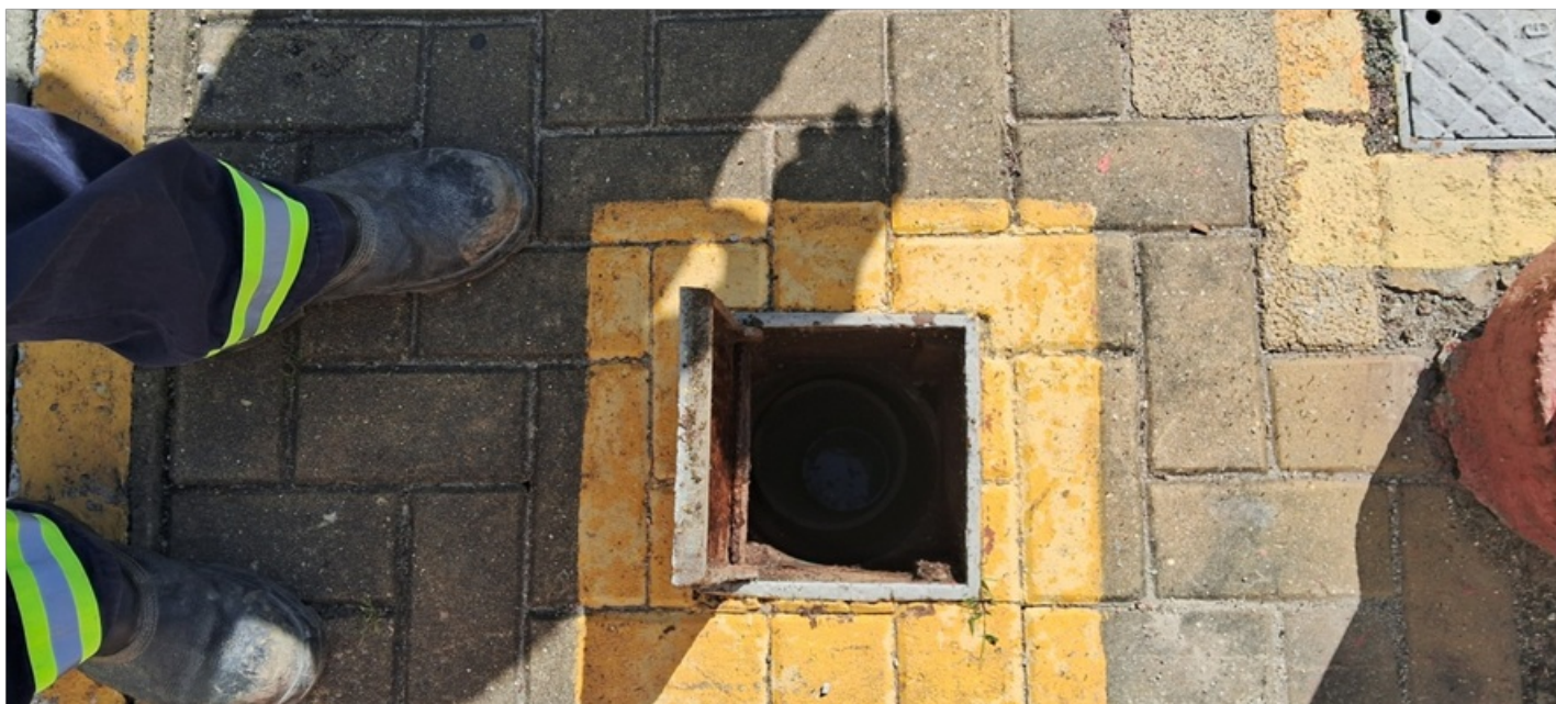
Foto 12 – Válvula de recalque
