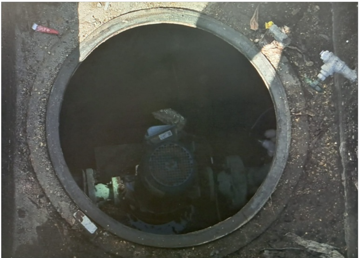
Foto 8 – Tubulações de recalque e retaguarda DN 100 mm
