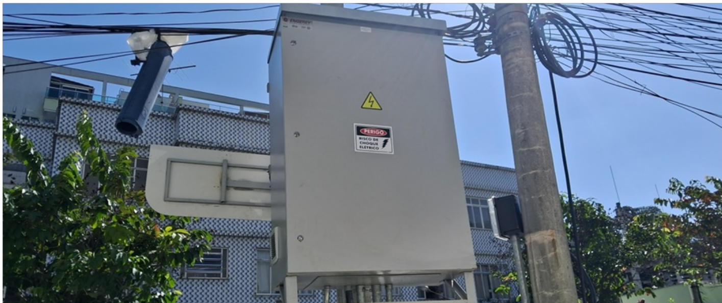
Foto 15 – Abrigo do painel da elevatória
